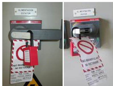
Consignación del seccionador Alimentación Rotor y Alimentación Estator. Locking and tagging out of the rotor and stator isolation switches.
