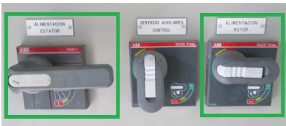
Seccionadores de Alimentación Estator (izquierda de la imagen) y Alimentación Rotor (a la derecha de la imagen) abiertos. Opened isolation switches for the stator power supply (left of the photo) and rotor power supply on the right of the photo.
